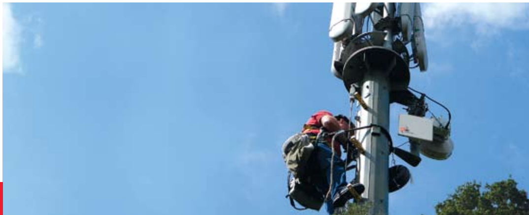
Instalação de Backhaul de Celular nos EUA
